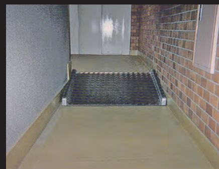
アルミスロープ 200 共用通路内のスロープ
